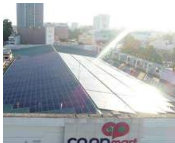
CO.OPMART BUÔN MA THUỘT 369,93 kWp
