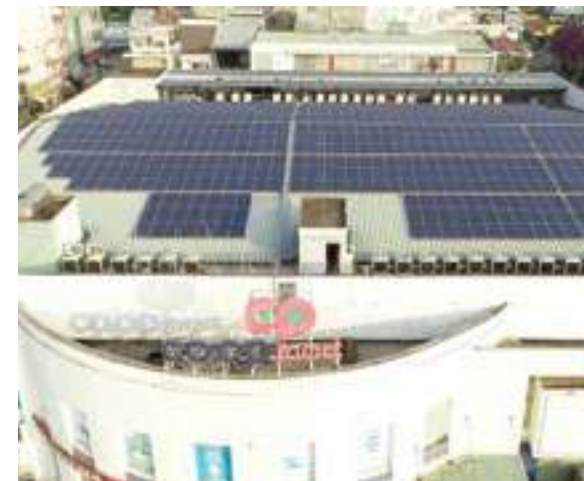
CO.OPMART ĐỒNG XÒÀI 282,15 kWp
